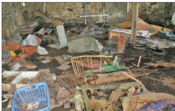
Im Inneren der Gebäude sah es so aus, wie hier auf dem Bild zu sehen – ein schlimmer Zustand mitten in Mobendorf.
