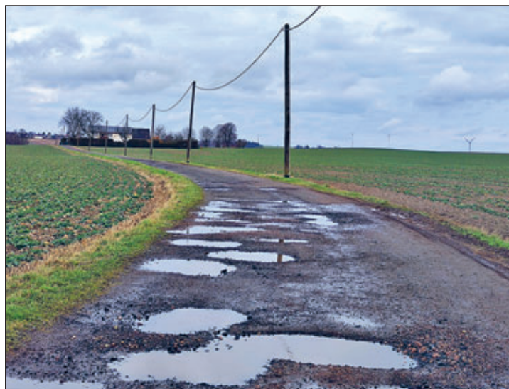
So sieht die kommunale Straße zu den Vier Linden in Etdorf im März dieses Jahres aus. Es ist das Anliegen der Gemeinde, die durch starken Regen entstandenen Schäden am Straßenkörper zu beseitigen.
