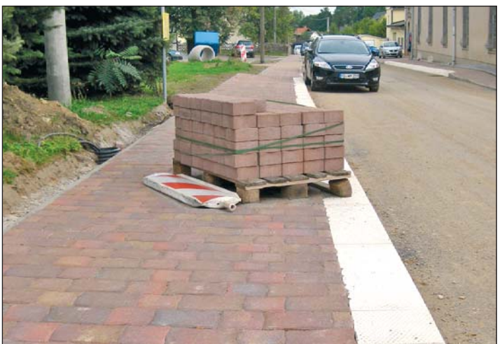
Herbstbuntes Altstadtplaster verlegt derzeit die Firma Walter Straßenbau KG aus Eitzdorf auf dem neuen Fußweg am Gasthof in Marbach.
