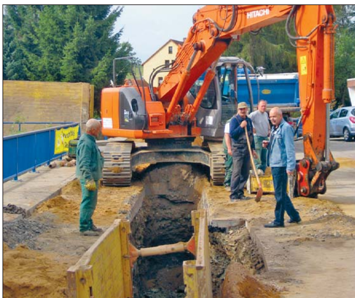
Fast vier Meter tief wird der Abwassersammler in Marbach durch die Firma LFT aus Ostrau verlegt. Diese Aufnahme vom 26. September 2012 zeigt den Bereich an der Grundschule.
