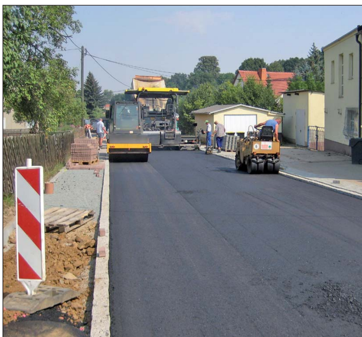
Insgesamt drei bituminöse Schichten in einer Gesamtdicke von 30 Zentimetern werden auf der neuen Ortsdurchfahrt eingebaut. Diese Aufnahme vom 22. August dieses Jahres zeigt Mitarbeiter der Firma Walter Straßenbau KG aus Etzdorf beim Einbringen der zweiten Bitumenbinderschicht im Bereich des Marbacher Gasthofes.
