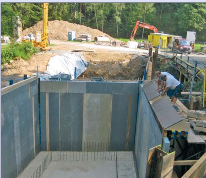
Die Fundamente für die neue Brücke über die Große Striegis in Mobendorf sind bereits betoniert. Die Arbeiten liegen dank der günstigen Witterungsbedingungen im Zeitplan. In den nächsten Wochen werden bereits die Arbeiten am Überbau über die Große Striegis zur Ausführung kommen.
