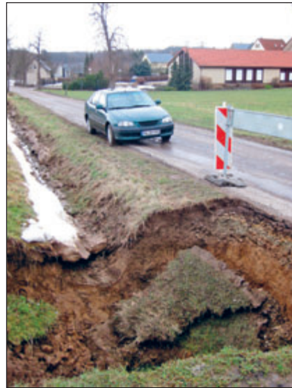
Unsere Aufnahme vom 26. Februar dieses Jahres zeigt den Geländeeinbruch an der Rosentalstraße in Marbach. Dieser ist so groß und tief, dass problemlos ein PKW darin verschwinden könnte.
